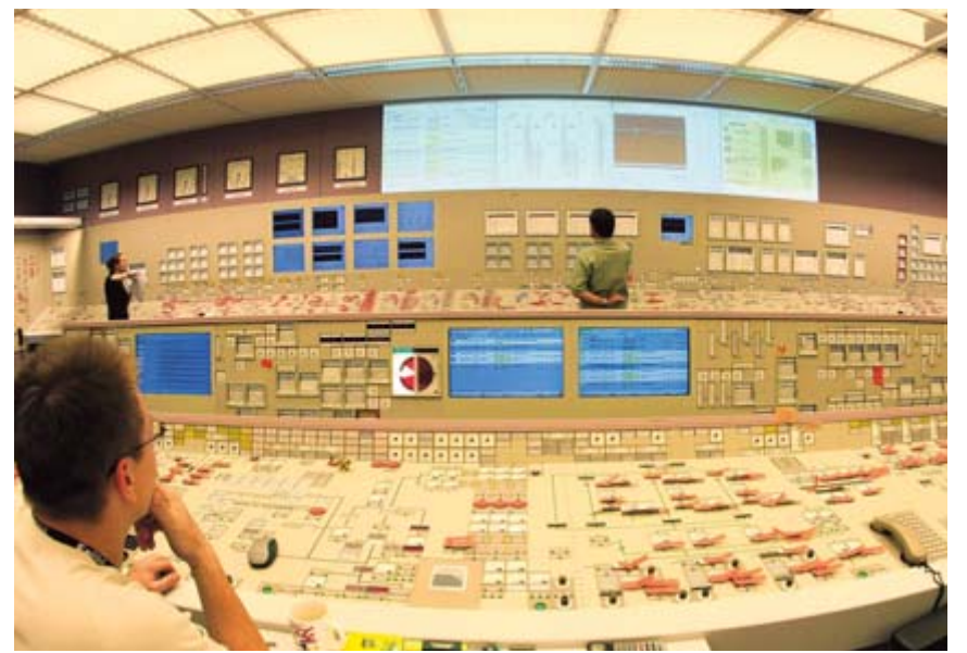
Blick in den Leitstand des Kernkraftwerks Philippsburg. Kraftwerke und Wassernetze werden immer häufiger von Viren und Würmern angegriffen. BILD: DPA
